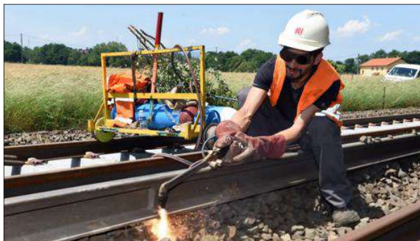
La majorité des travaux auront lieu sur la ligne Valence-Gap. Photo DR
